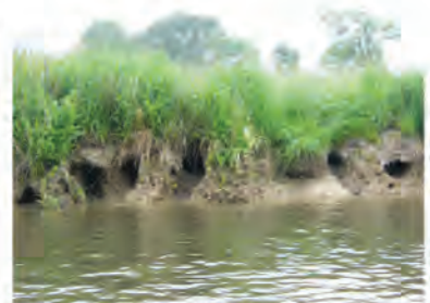
Dégâts sur berge
